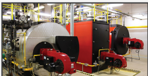
Λέβητες πετρελαίου και αερίου
